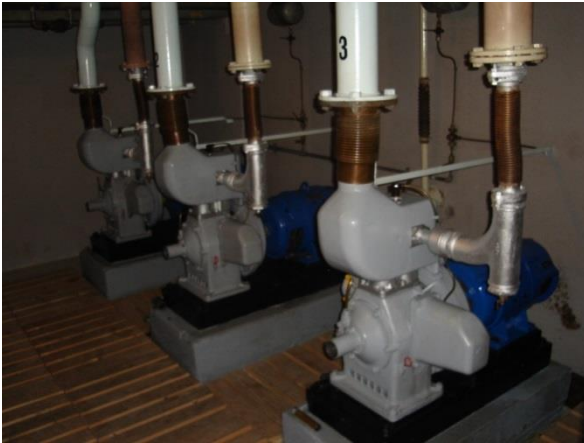
Zürcher Motoren im Maschinenraum
